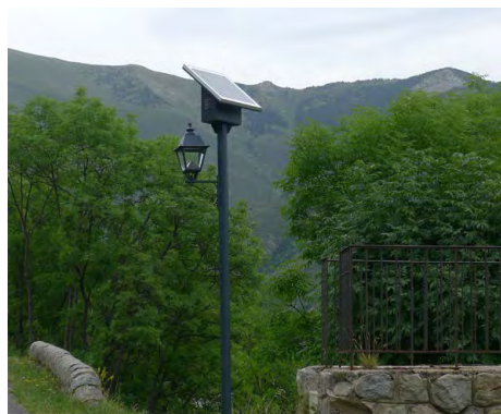
Lampadaires à énergie renouvelable dans les Garrotxes
