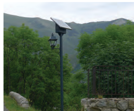
Lampadaires à énergie renouvelable dans les Garrotxes
