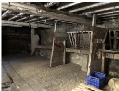
Sous-sol - sol à reprendre
